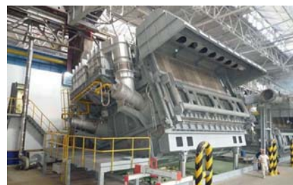
Плавильная печь емкостью 65 т спроектирована и установлена в 2010 г. компанией IST на Каменск-Уральском металлургическом заводе (КУМЗ)
