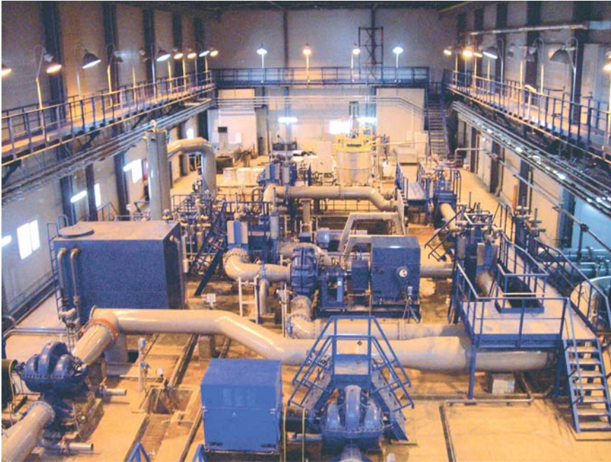
Оборудование совмещенной насосной станции хвостового хозяйства
