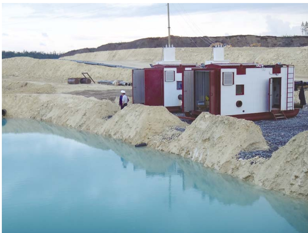
Станция на карьерном водоотливе, оснащенные насосами 1Д630
