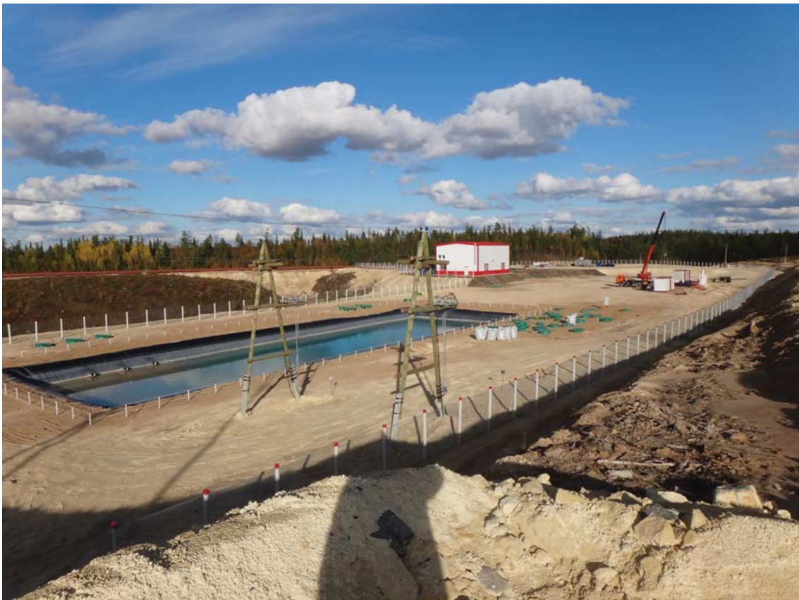
Первая очередь очистных сооружений карьерных и отвалных вод первой (а) и второй (б) ступеней очистки
