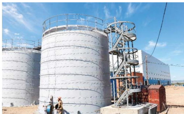
Рис. 3. Станция очистки шахтных вод рудника № 6 ПАО «ППГХО»
