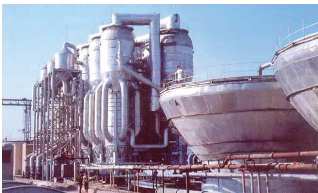
Завод по производству дистиллята на базе АЭС с реактором БН-350, г. Шевченко (Актау)
