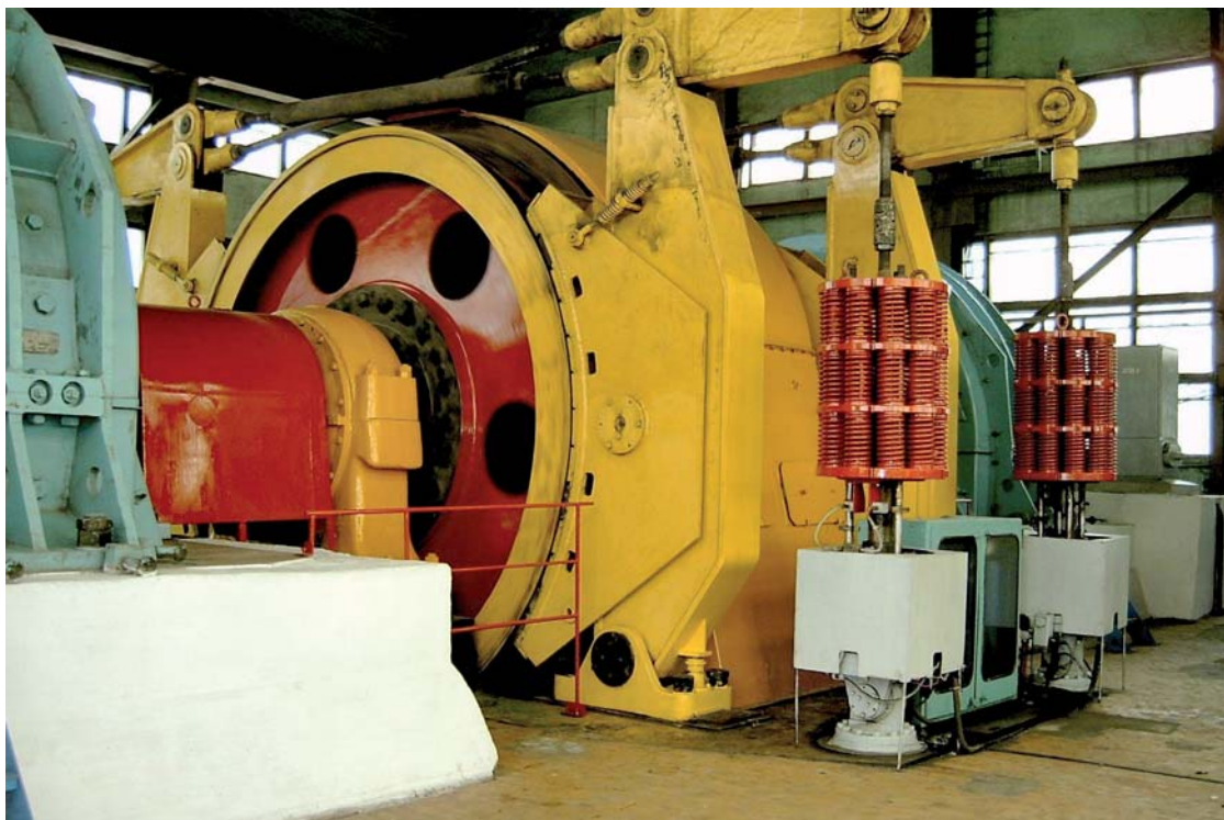
Подъемная машина ЦШ5-8 на главном стволе
