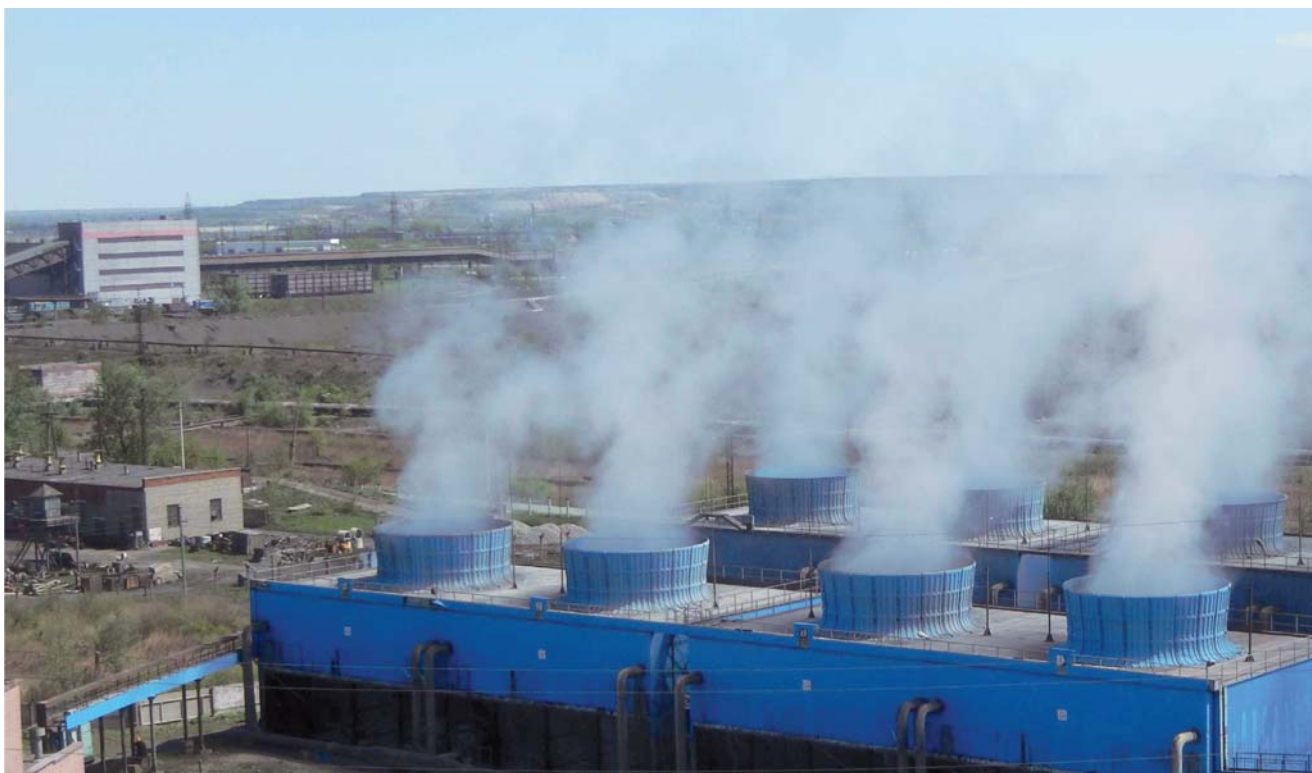
Четырехсекционная вентиляторная градирня чешской компании FANS
