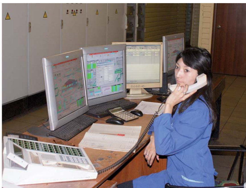
АРМ оператора обжиговой машины
