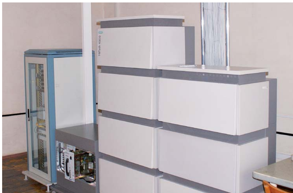
Автоматическая телефонная станция HiPath 4000
