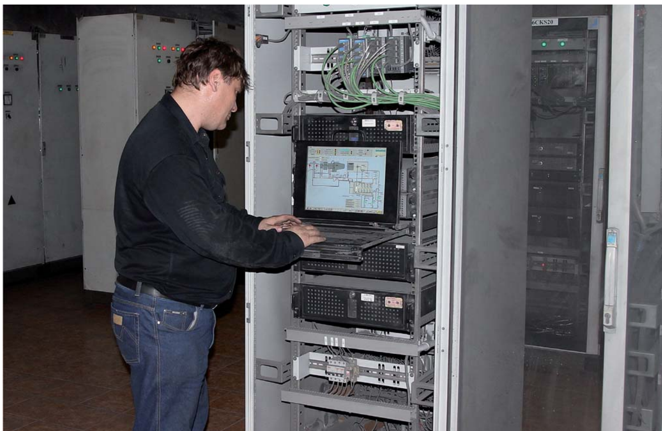
Аппаратная АСУТП энергоблока № 6 ТЭЦ АО «ССТПО»
