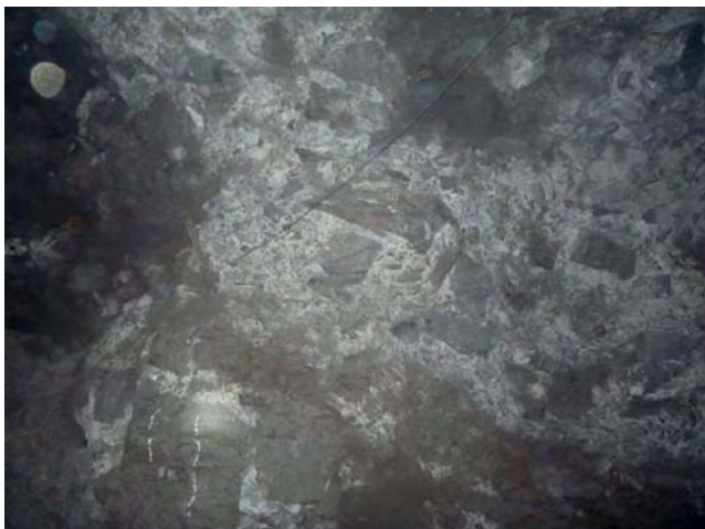
Рис. 2. Обнаженный бутобетон в западном боку заезда на ленту 227 рудника «Октябрьский» с образованием купола
