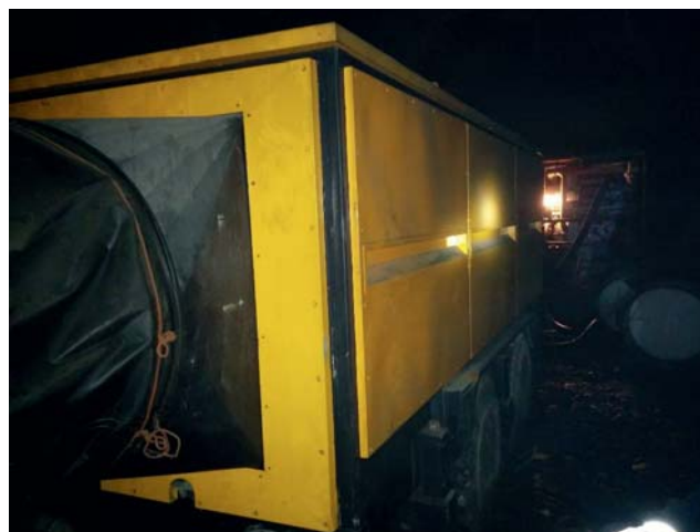
Рис. 3. Фотоснимок системы кондиционирования КШР-350Н, установленной в выработке РО-23 юг, на участке между РШ 23-29-1 и ТШЛ-36
