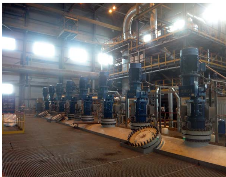
Переработка упорных руд в автоклавном цехе Амурского ГМК ОАО «Полиметалл»
