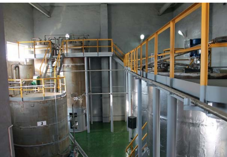
Опытно-промышленная установка по извлечению скандия из оборотных растворов СПВ
