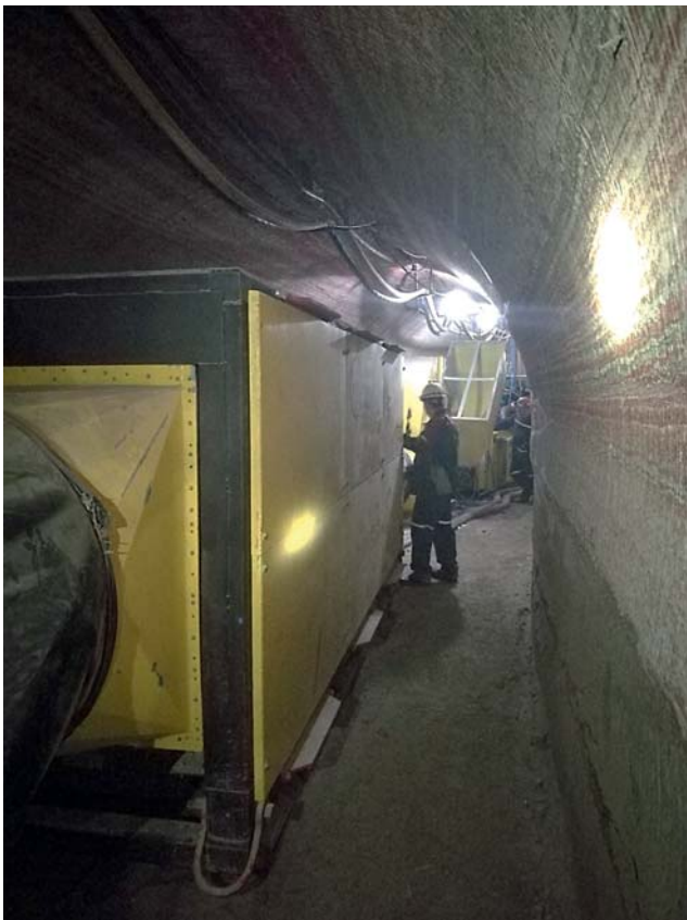
Рис. 5. Установленные в технологической сбойке воздухоохладитель и вентилятор системы кондиционирования воздуха
