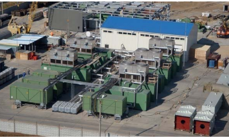
Мобильный блок замораживающей станции мощностью 10 МВт. Гремячинский ГОК, Волгоградская область, РФ
