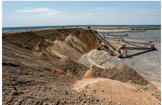
Установка кучного выщелачивания
