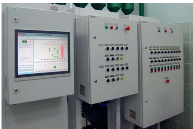
Рис. 4. Типовые шкафы управления и ЦСУ
