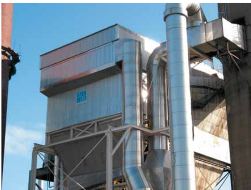
Рис. 1. Установка для очистки отходящих газов
