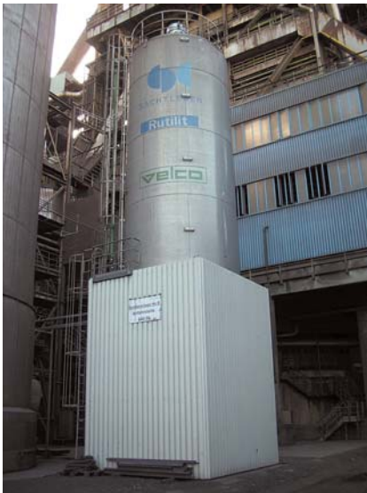
Инжекционная установка для доменной печи В фирмы НКМ
