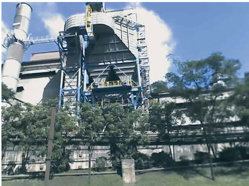
Рис. 4. Установка системы электростатических фильтров (ESP)
