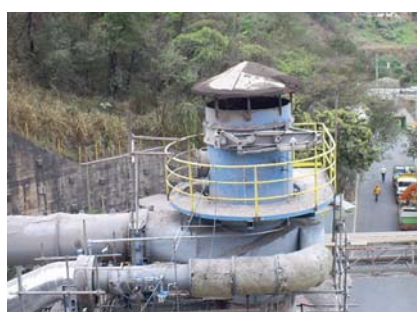
Рис. 3. Дымовая труба с обеспыливающим устройством
