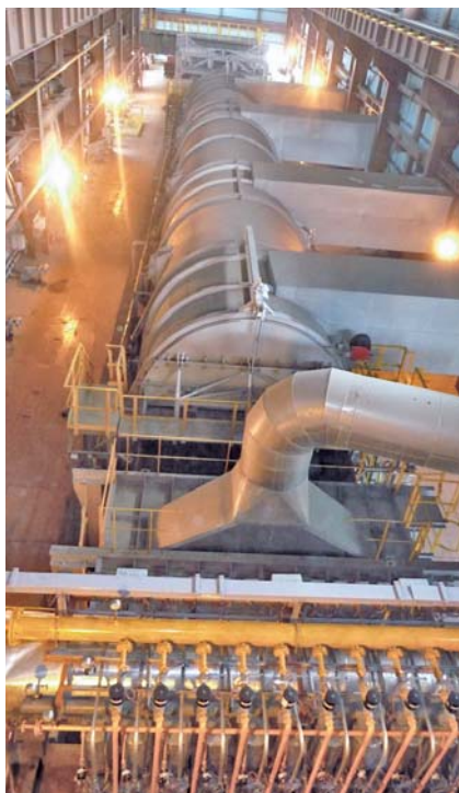
Рис. 4. Вид на ленту агломерационной машины; показаны также зажигательный горн, газоходы для рециркуляции отходящих газов и вытяжной зонт
