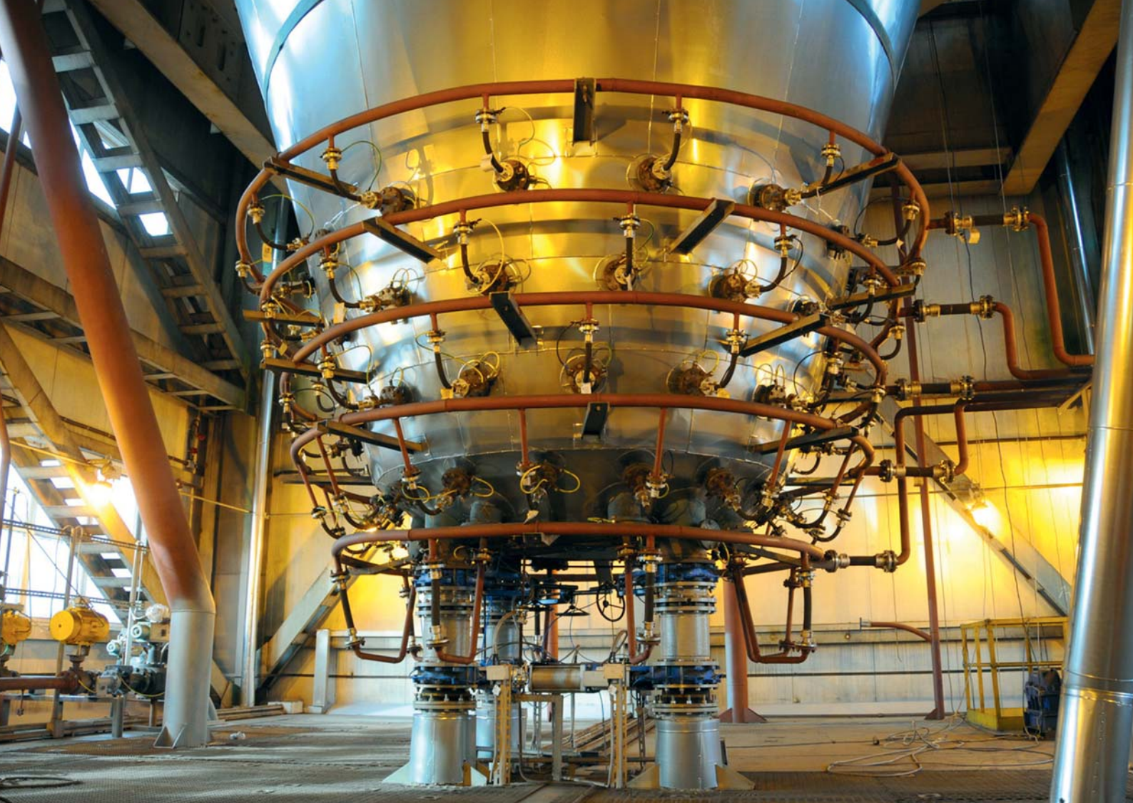
Оборудование для вдувания порошкообразного угля, установленное на доменной печи
