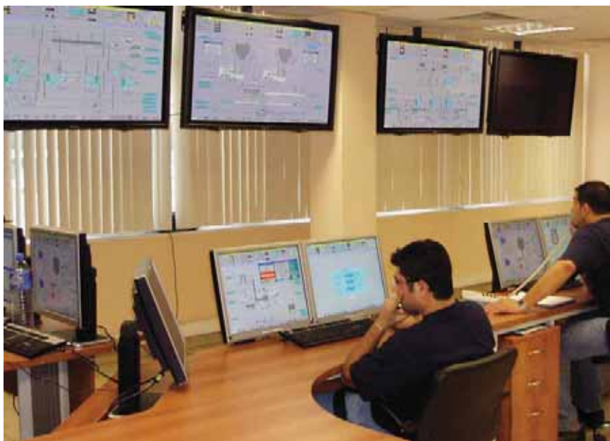
Рис. 1. Пульт управления цеха по переработке побочных продуктов коксохимического производства
