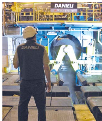
Рис. 5. Подпольная моталка для горячекатаной полосы
