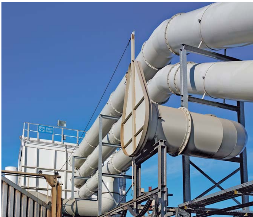
Затвор и три дымохода, обслуживающие вытяжные камеры
