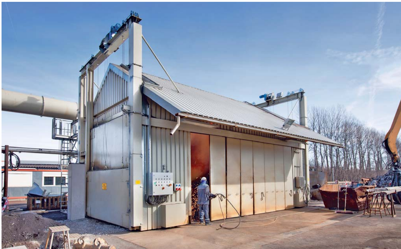
Новая вытяжная камера на рабочей площадке компании RRD
