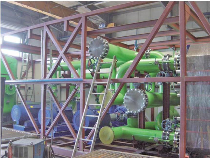
Насосная станция без крыши и одной стены
