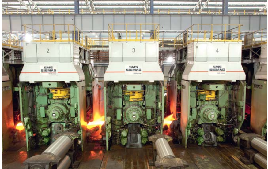
Прокатные клетки стана горячей прокатки полосы в линии агрегата CSP®
