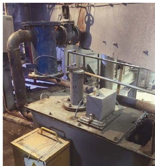
Установка поточного гранулометра ПИК-074П и плотномера РП-24 на станции контроля параметров пульпы на обогатительной фабрике «Эрдэнэт», Монголия
