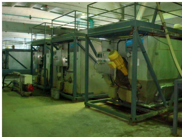
Поверхностный комплекс (цех) по изготовлению компонентов ЭВВ для производства БВР в карьерах
